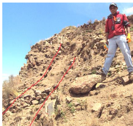
Foto 1: Grietas de tracción en la cresta del talud.
